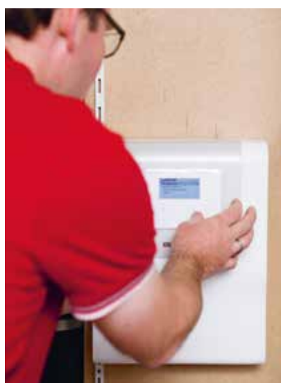
Zur Inbetriebnahme gehört auch das Einstellen der Heizkurve.
