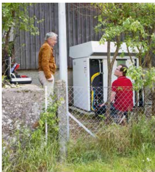
Die Büsche wurden für den Austausch der Wärmepumpe extra zurückgestutzt.
