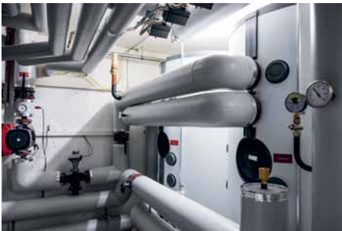
Die Pufferspeicher SBP 1500 E sorgen für warmes Heizwasser.
