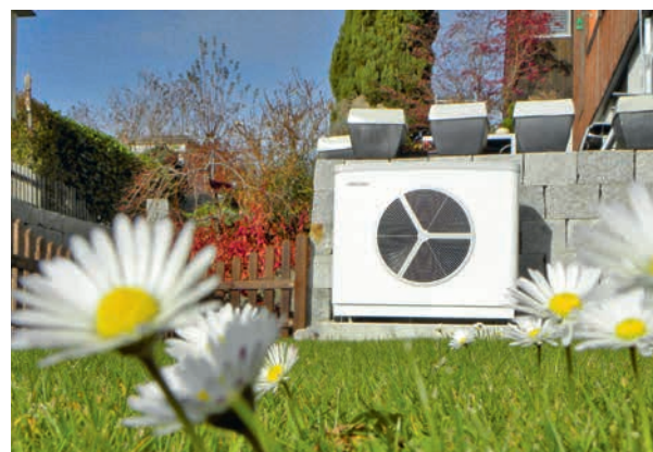
8 | Installation témoin à Affoltern am Albis
