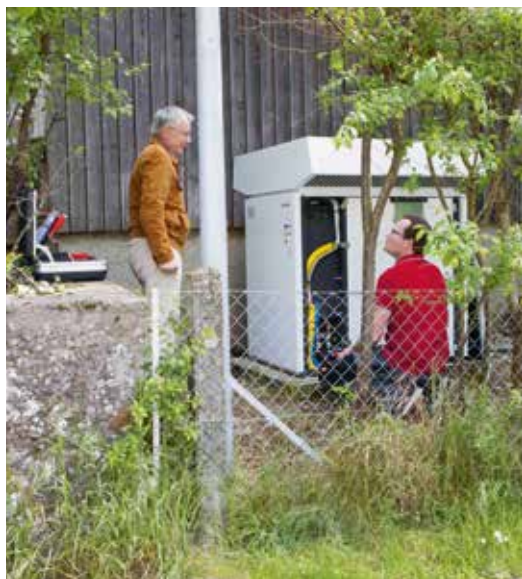
Les buissons ont été spécialement taillés pour le remplacement de la pompe à chaleur.
