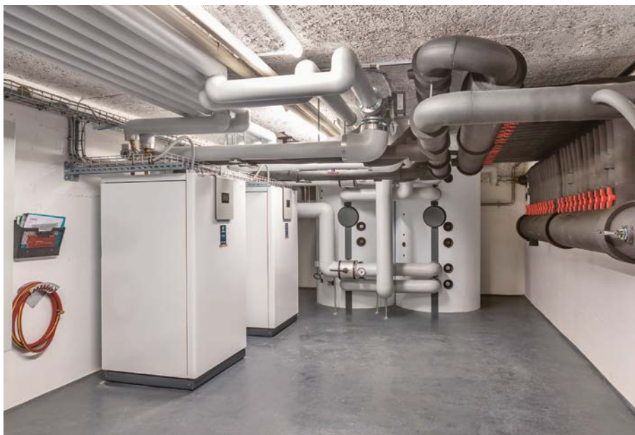
Cascade de 2 pompes à chaleur géothermiques WPE-I H Premium à régulation inverter.
