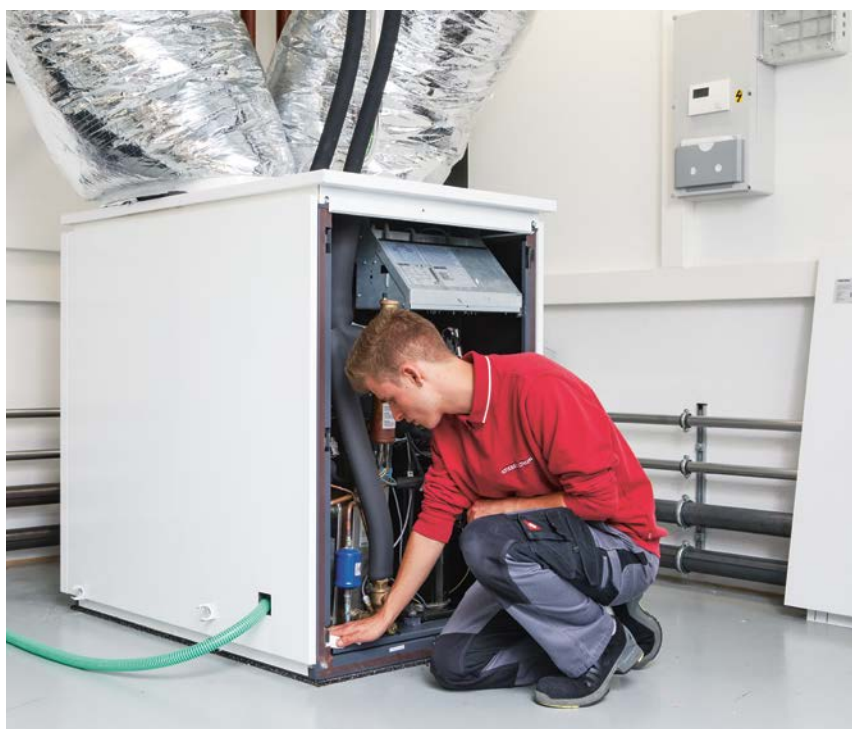
Tecnici della manutenzione all'opera
