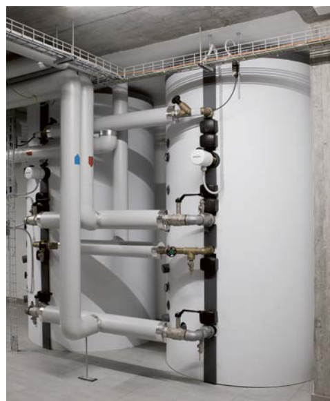
Acqua potabile con abbattimento della legionella grazie a scaldacqua istantanei: il serbatoio di acqua calda SBS 1501
