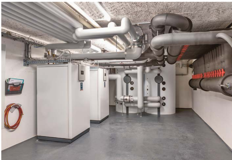
Cascata composta da 2 pompe di calore con sonda geotermica WPE-I H Premium con regolazione mediante Inverter
